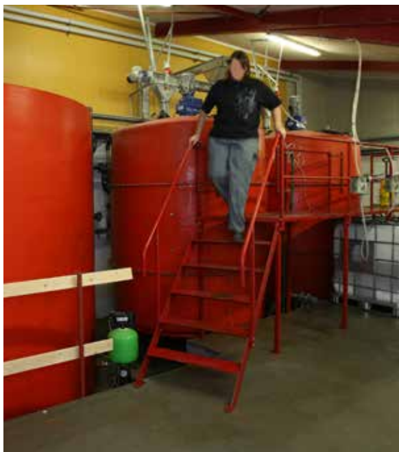
Platform ved vådfodertank etableret med rækværk og gelænder som alternativ til at stå på en stige.
